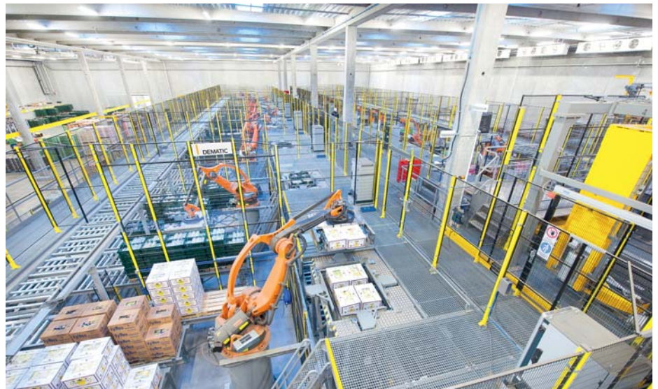
Blick in den Kommissionierbereich: Insgesamt sind 15 Roboterzellen hintereinander positioniert
