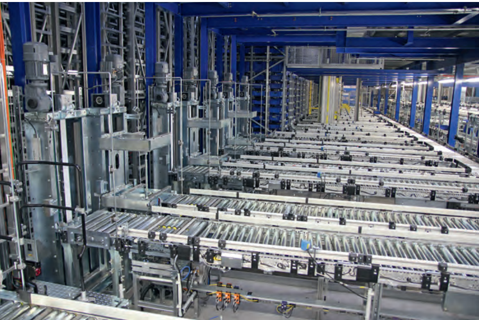
Das „Parts Logistics Center“, das Stute für Claas betreibt, bietet 28.800 Palettenstellplätze, 22.100 m Regale für Großteile sowie ein Automatisches Kleinteilelager.
