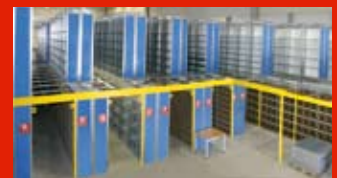
Kombiniert Regalsysteme im von Cat Logistic betriebenen GM Logistikcenter
