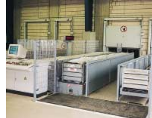
Längsseitige Kommissionierstation mit Kundenkassette
