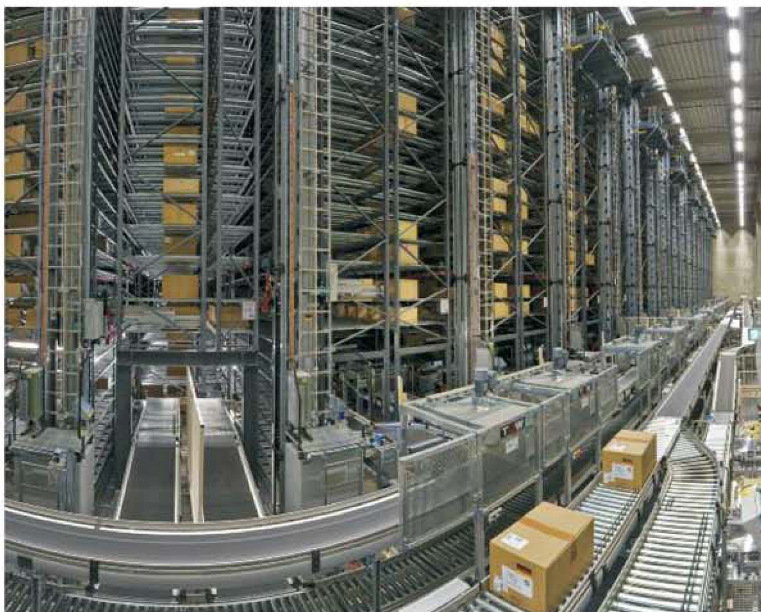
Vollautomatische Kartonlagerung von TGW als Basis für die effiziente Kommissionierung im Textilhandel
