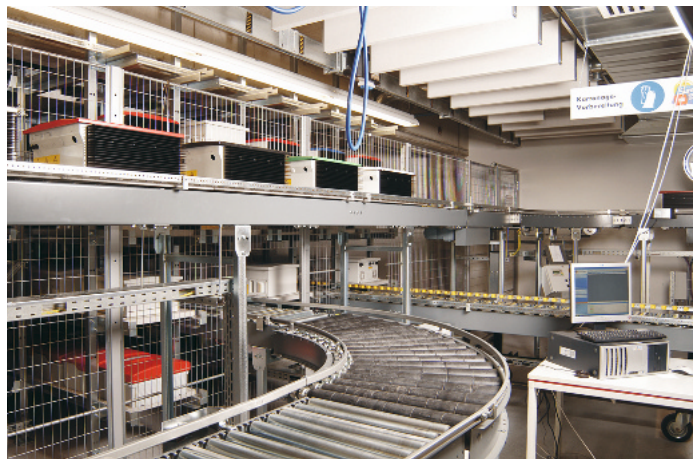
Blick in die Vorzone des Automatischem Kleinteilelagers mit zweigeschossiger zu- und abführender Fördertechnikstrecke
