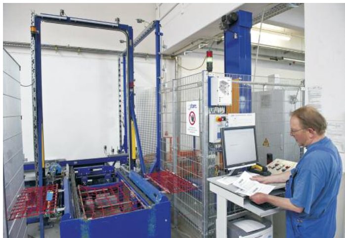
Direkt neben der Konfektionierung wird die verpackte Ware auf die Fördertechnik aufgegeben und auf Störkonturen geprüft
