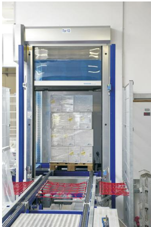
Schleusen am HRL-Zugang sorgen für einen konstanten Luftsauerstoffgehalt von 13,4 %
