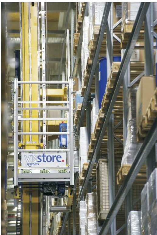
Versorgt werden die 3 600 Palettenstellplätze von drei RBGs des Typs Viapal
