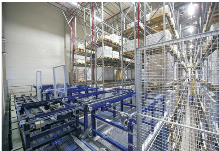
Am Wareneingang werden die Paletten jetzt über einen Verschiebewagen auf die Einlagerstiche gesetzt
