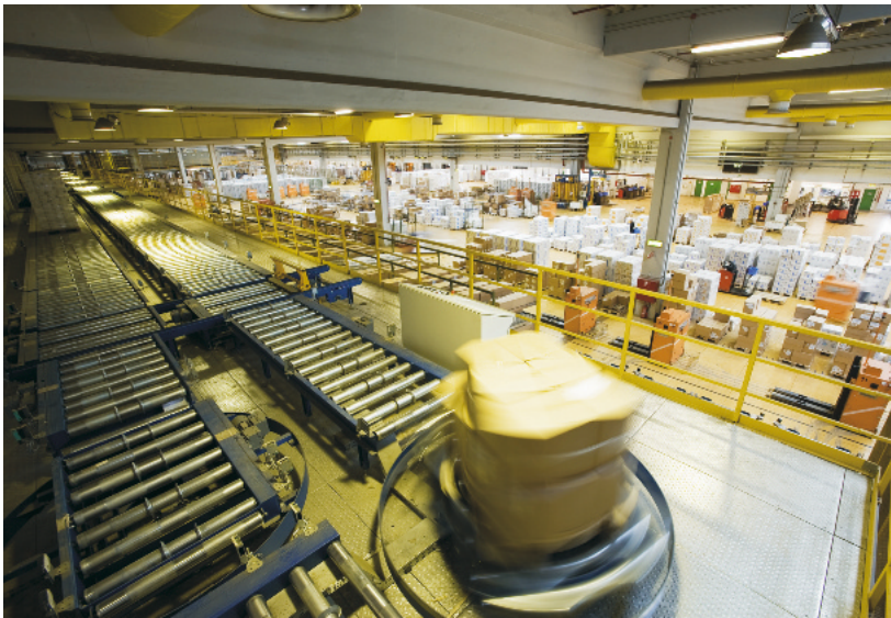
Blick in die bereits bestehende Kommissionierhalle des Hartmann-Logistikzentrums Süd. Die Fördertechnik wurde im laufenden Betrieb an den neuen Teil des Logistikzentrums angebunden
