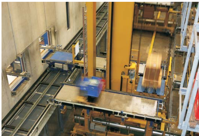
Ein- und Ausgang zum automatischen Hochregalpalettenlager; außerhalb werden die Paletten weiterbefördert
