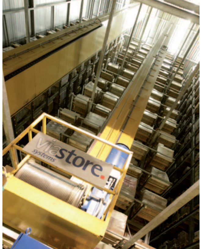
Das fünfgeschossige, automatische Palettenlager wurde komplett modernisiert. Die Lebensdauer konnte damit um Jahre verlängert und eine hervorragende Logistikleistung garantiert werden.
