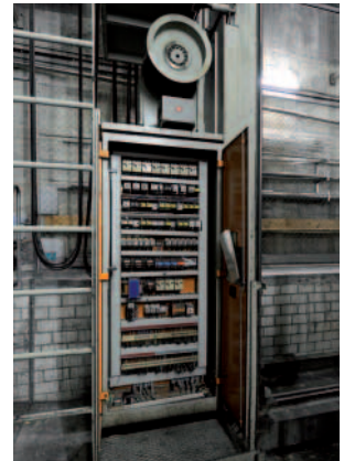
Vorher: Die Steuerungen waren veraltet, die Regalbediengeräte liefen unzuverlässig und langsam.
