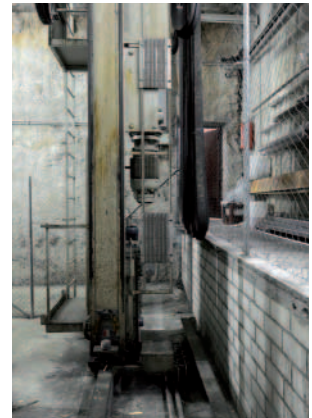
Vorher: Die Antriebe für Hub- und Fahrwerke entsprachen seit langem nicht mehr dem Stand der Technik.
