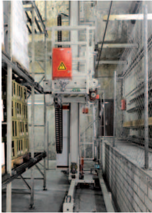
Nachher: Die neuen Antriebe sorgen dafür, dass die Paletten mit Weinflaschen zuverlässig und schonend gehandhabt werden.
