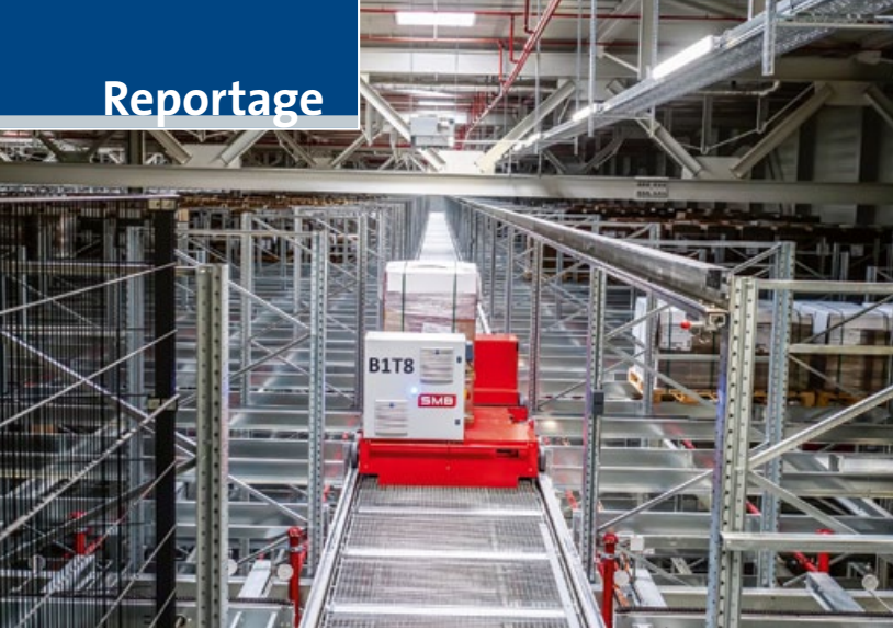
Schiettinger nutzt das Truck-Shuttle-System des Unternehmens SMB. In Summe 24 Shuttles sorgen für die Ein- und Auslagerung der Paletten.
