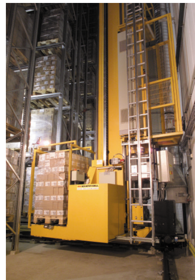
Bild 4 Mit der geforderten Ein- und Auslagerung von 100 Paletten pro Stunde stößt das HRL längst noch nicht an seine Kapazitätsgrenzen.
