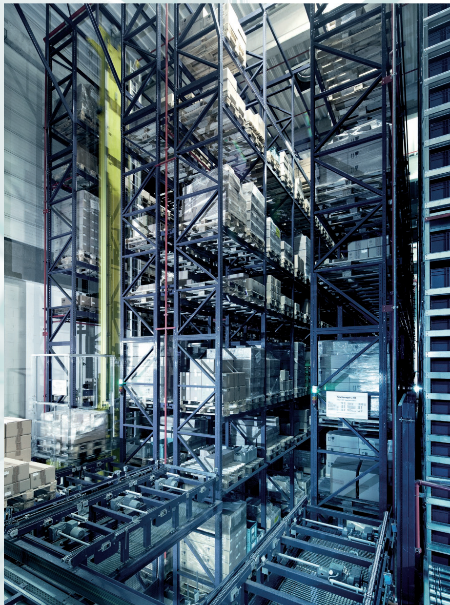
01 Im zweigassigen automatischen Paletten-Hochregallager finden 1 036 Paletten Platz
