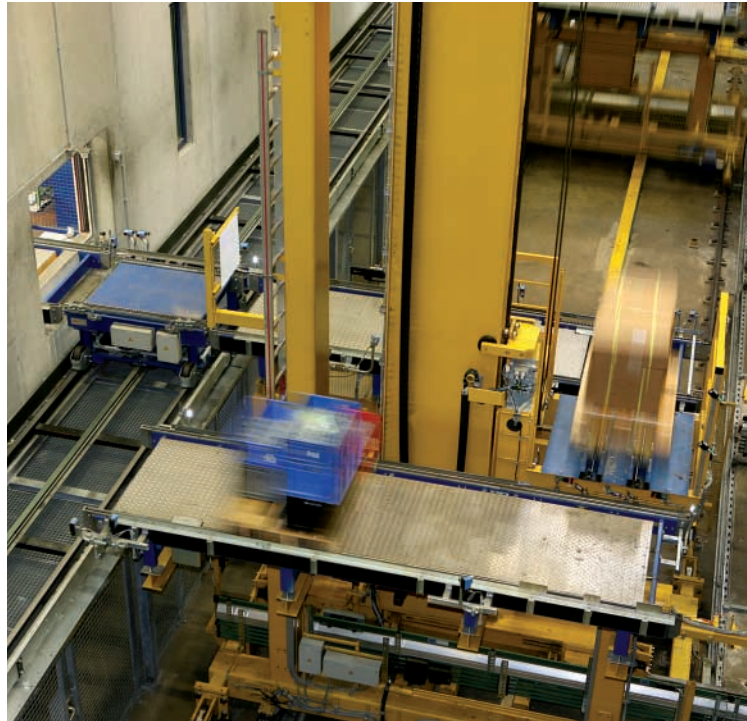
Ein- und Ausgang zum automatischen Hochregalpalettenlager; außerhalb werden die Paletten weiterbefördert.
