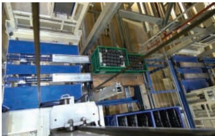
Das RBG viapal stemmt alles, was bis zehn Tonnen wiegt. Bei Mekra Lang sind die Paletten allerdings nicht schwerer als 1,1 Tonnen.
